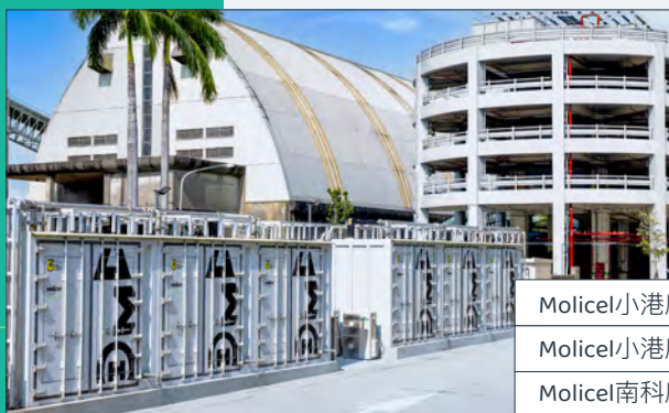
電池廠首例 設置EnergyArk儲能系統
